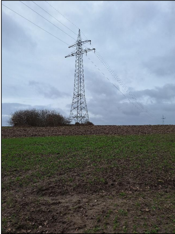
Abbildung 4: Freileitungsmast im Vorhabengebiet (Foto: Planungsbüro ALSE, 20.02.2024)
